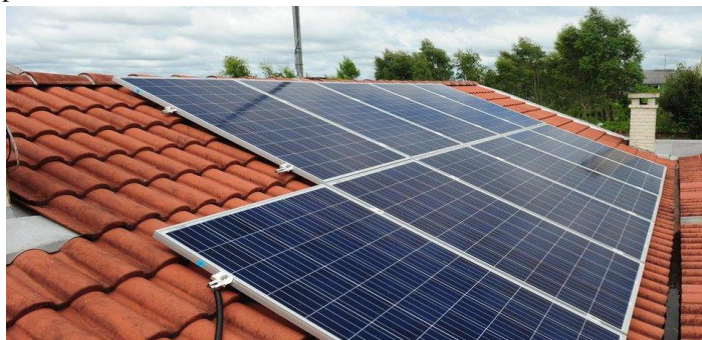
Figura 1 - Conjunto de placas fotovoltaicas instaladas em um telhado.
