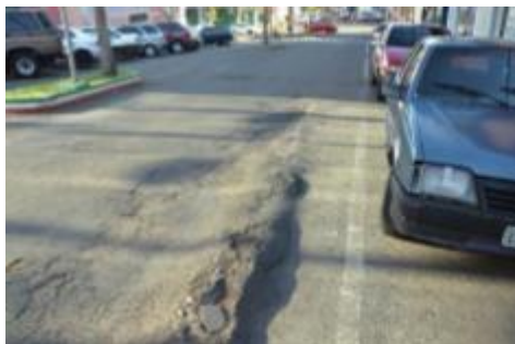
Figura 5 – Patologias do asfalto nas vias. Fonte: resultado do Diagnóstico, 2015.
