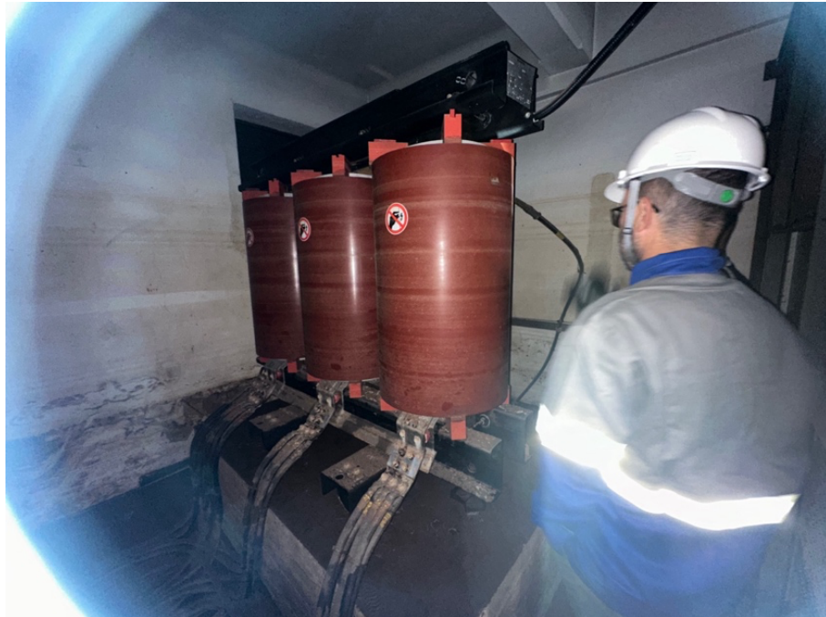
Figura 2: foto de um transformador a seco onde ocorreu alagamento (não é o mesmo que fora recuperado e alvo deste estudo)
