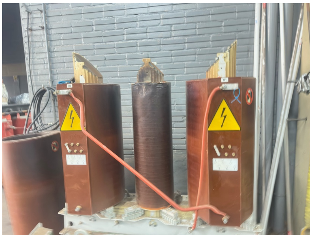
Figura 5: foto de um transformador que apresenta problemas e não pode ser recuperado.
