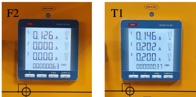
Figura 3 – Medidores F2 e T1 no ensaio com carga média.
