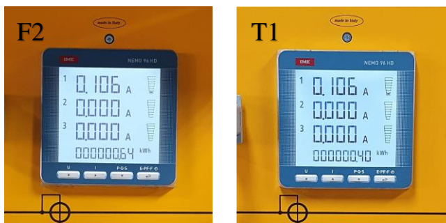
Figura 4 – Medidores F2 e T1 no ensaio com a carga desconectada.
