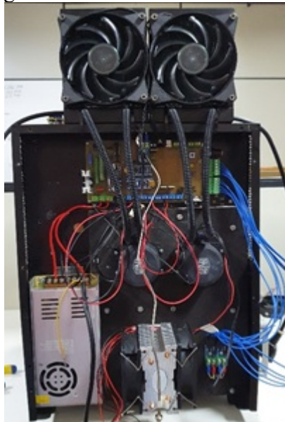
Figura 2 – Montagem sistema resfriamento e fonte de alimentação.
