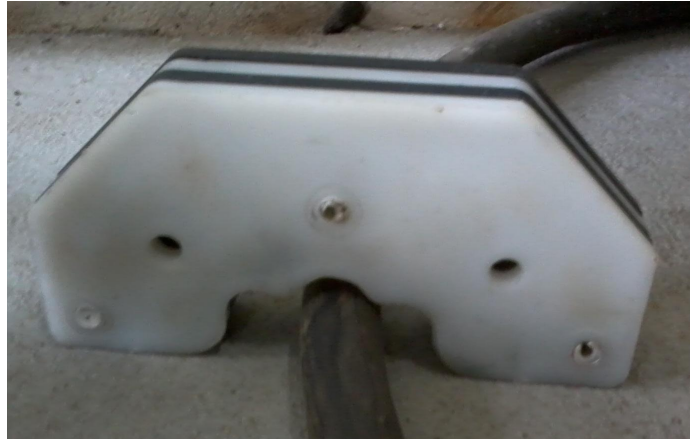
Figura 1 – Dispositivo instalado no cabo de energia
