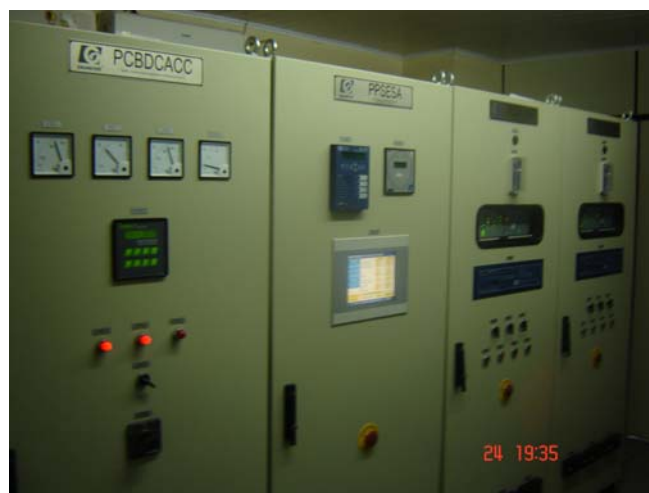
Figura 1 – Foto dos quadros de controle da Usina Passo do Ajuricaba
