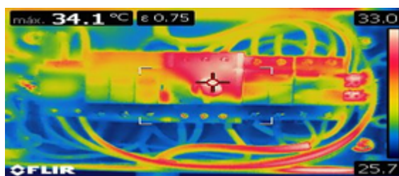
Figura 3. Foto térmica do circuito CC e CA.
