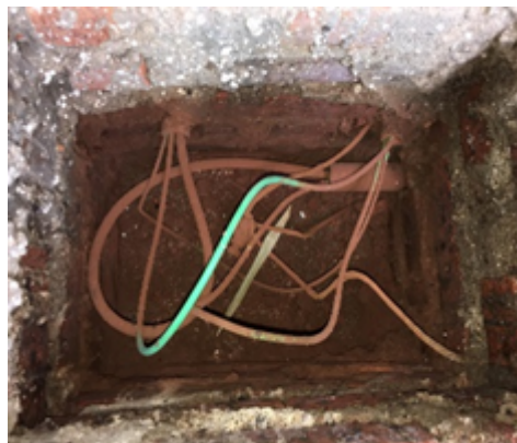
Figura 5. Caixa de inspeção do aterramento do SFV.
