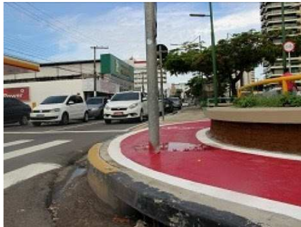
Figura 2 - Cadeirante e especialista apontam falhas em obra de ciclovia
