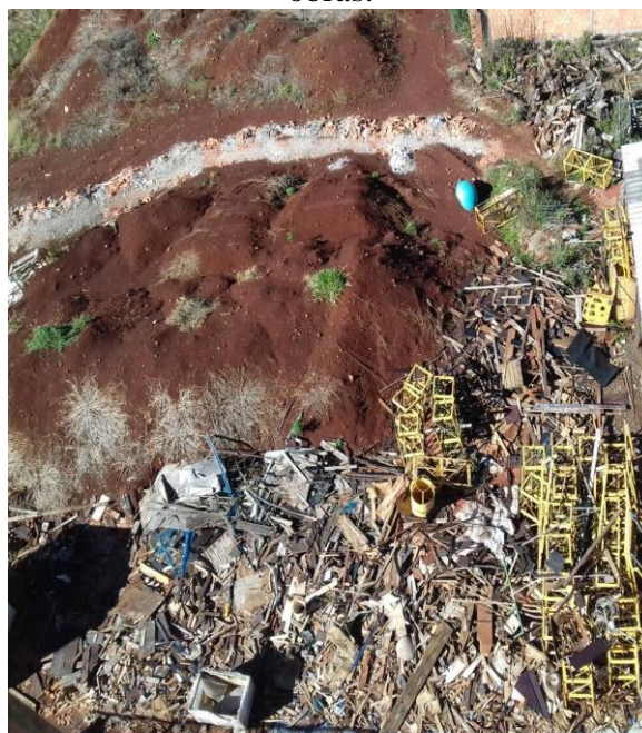
a) Resíduos de fôrmas de madeira e compensados, paletes e restos de concreto e tijolos quebrados.
