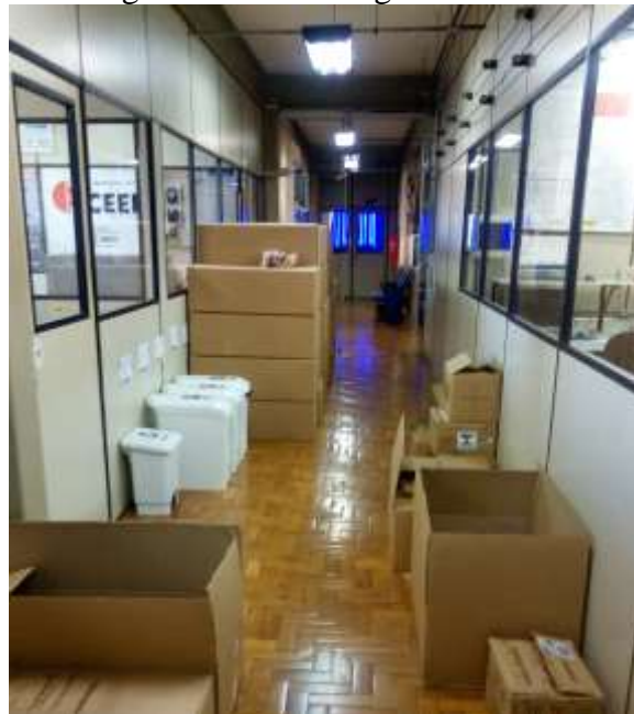
Figura 1. Rota de fuga obstruída.
