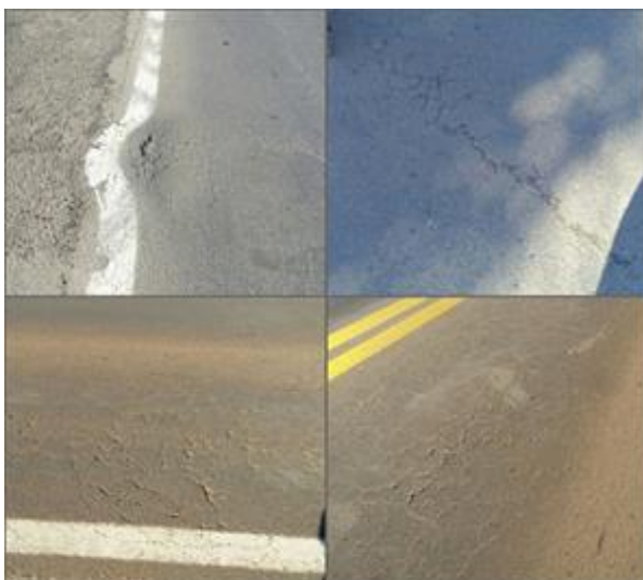
Figura 2. Patologias em pavimentos flexíveis
